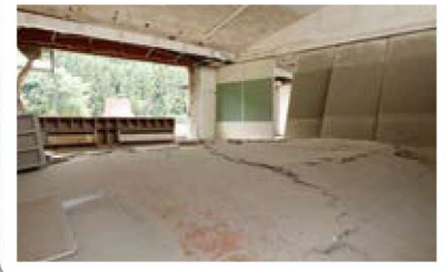
津波の威力で盛り上がった床
