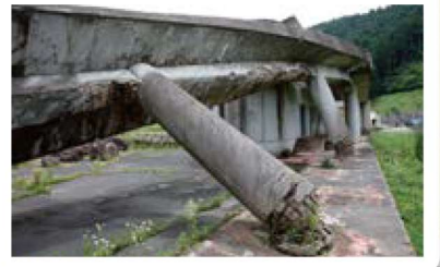
ねじり倒された渡り廊下
